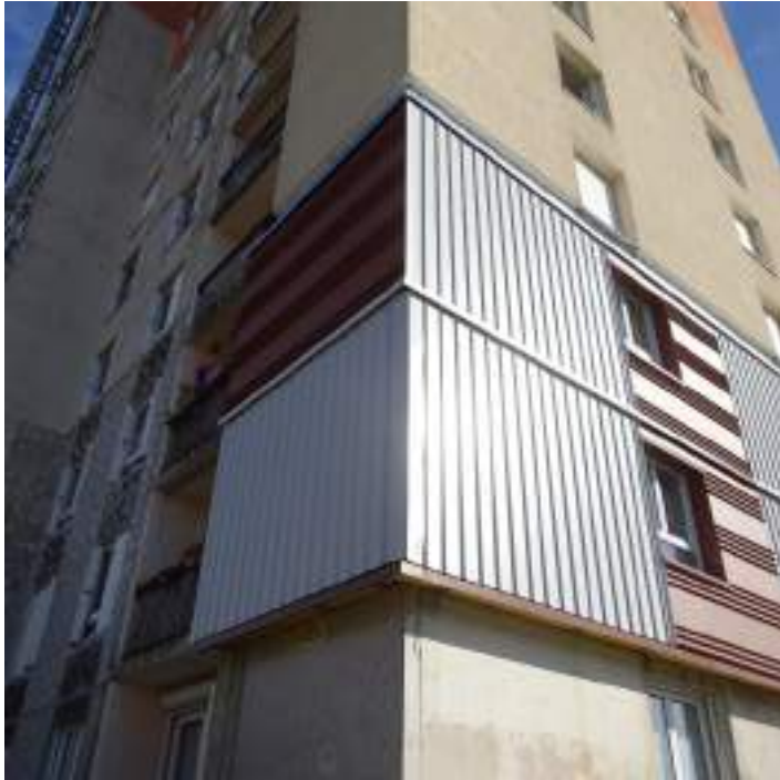
Les murs de FOB posés, ici avec un revêtement extérieur en bac acier.
